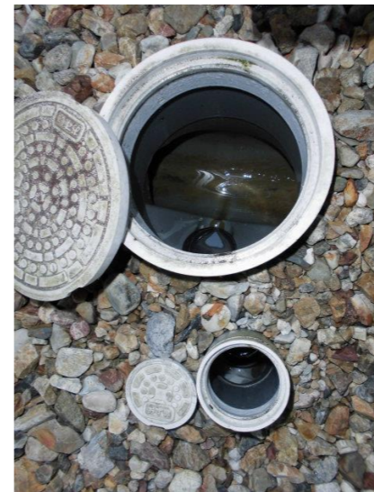
D 洗面からの排水
